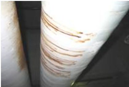
写真-2.3 熱水配管
