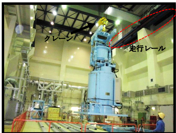
使用済燃料貯蔵建家天井クレーン
