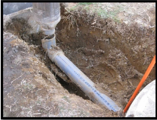
排水管の損傷（補機冷却水設備 A 系統側）
