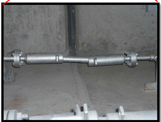
地盤沈下により、原子炉建家と共同溝にズレが生じ配管接続部が変形
