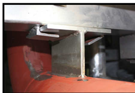
シューの異常なし
