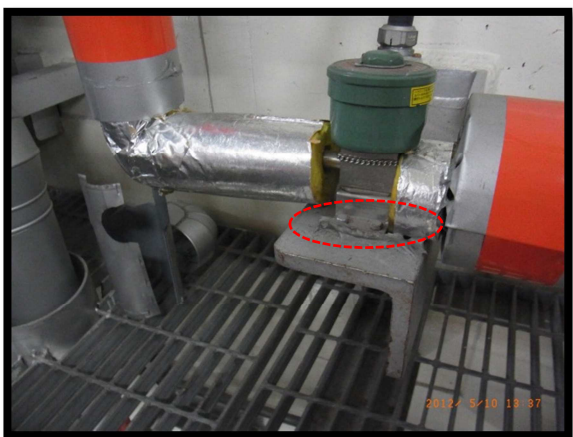
緩みのあった弁固定ボルト
