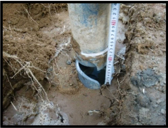
排水管の損傷（補機冷却水設備 B 系統側）
