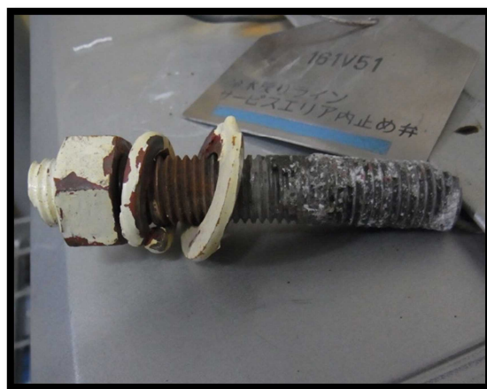
取り外した不良アンカーボルト
