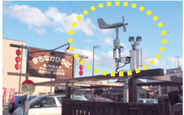
データの安定性や初期故障等を確認するために試験中の遠隔監視システム（南相馬市内）
