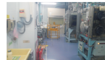
事故現場(108号室H-1フードの様子)
