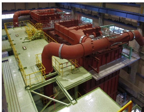
加熱器本体 最大出力30MW x 2基
