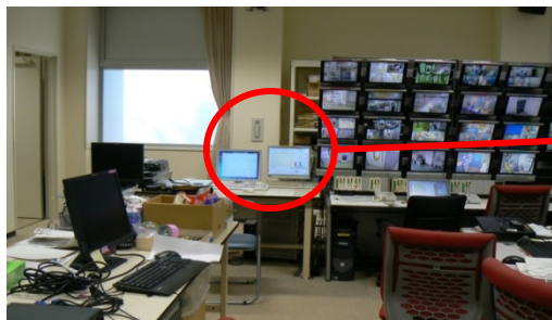
放射線監視端末 (中央制御棟コントロール室内)
