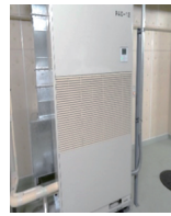
空調設備更新による 高効率化
