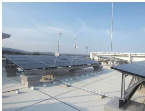
2015年10月から運用を開始した檜葉遠隔技術開発センター屋上の太陽光発電設備
