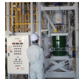
セメント固化設備の実証プラント規模試験により試験データを取得
