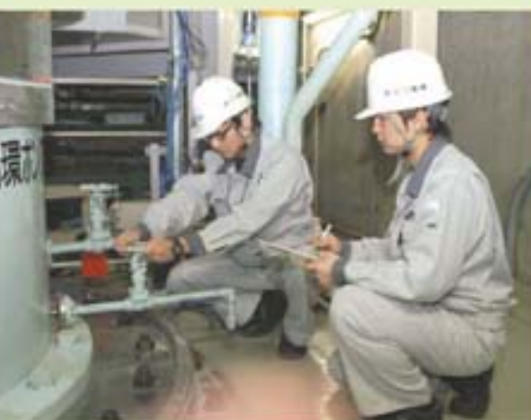
●性能試験前準備・点検の最後の段階、起動前点検(2次系Aループ点検)
