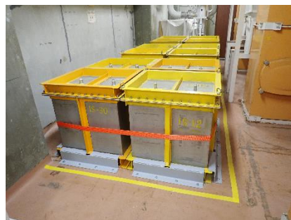
ヨウ素フィルタ保管容器の連結・床面への固定
