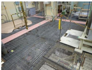
②の例(グレーチング)
