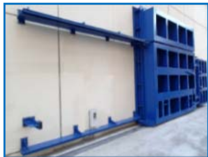
浸水防止扉(設置済み)
