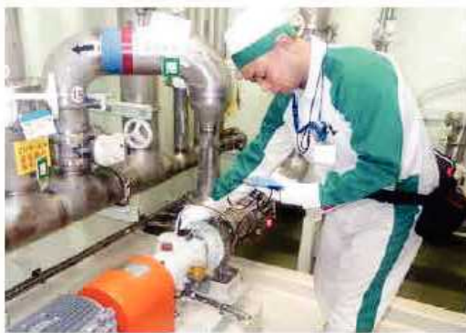
③ 月例点検(冷却水ポンプ)
