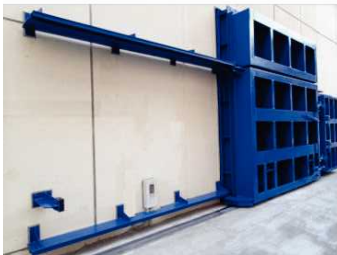
HAW施設の浸水防止対策の例(スライド式扉)
