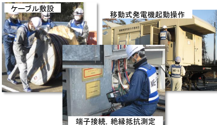
移動式発電機からの給電操作
