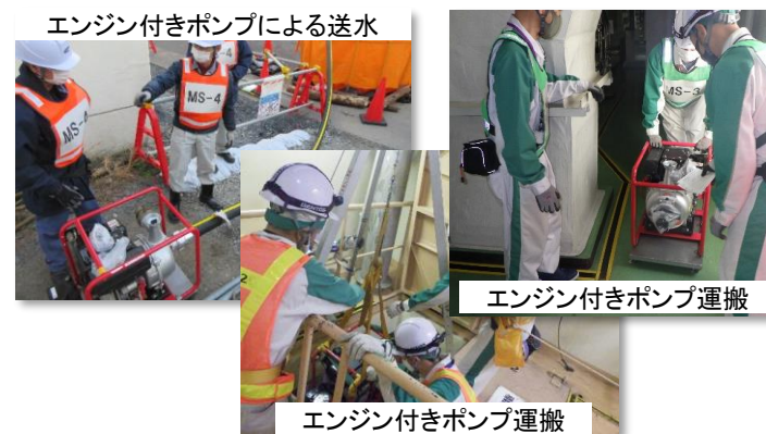
エンジン付きポンプを用いた外部からの給水操作
