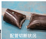
配管切断状況
