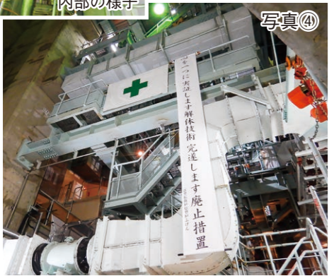
1階フロアよりAループ全景を望む
