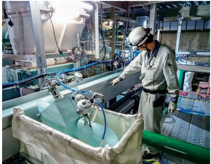
ナトリウム移送前の配管等の設置状況を確認した時の様子
