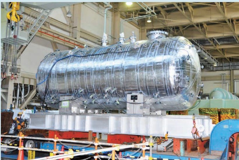
タービン建物に仮置中の一時保管用タンク
