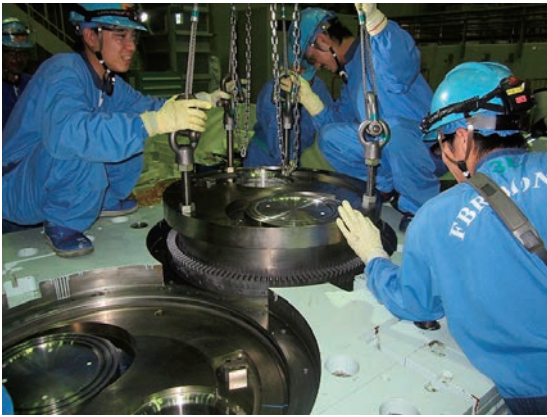
保全計画に基づく燃料処理・貯蔵設備の点検作業（炉外燃料貯蔵設備の点検）
