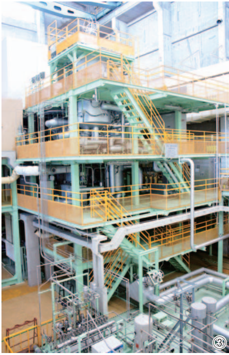
【PLANDTL】高速炉の炉心部等のナトリウムの流れや熱の移動を研究するための試験施設（高さ約20m）
