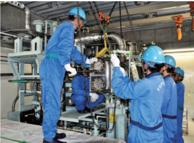
現場の点検作業（廃ガス圧縮機点検）
