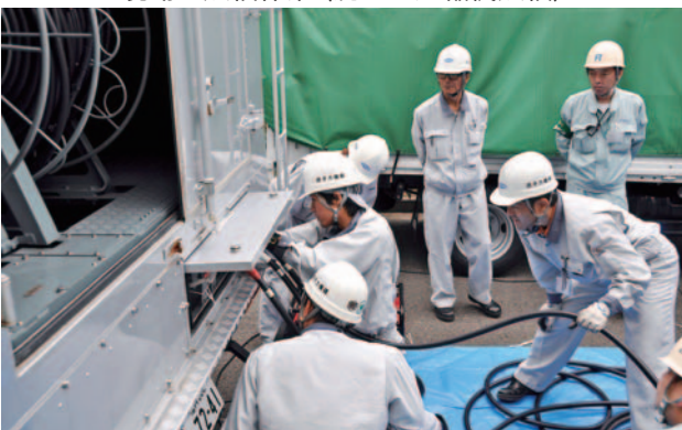
定期的な緊急時対応訓練（電源車ケーブルつなぎ込み）
