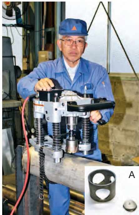
試作品の配管にチェーンの円筒形部分（配管左部分）で固縛し、切削工具で穴を開ける
