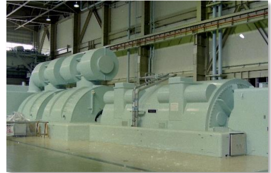
タービン発電機
