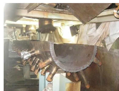
分配管(原子炉入口管)の溶断面
