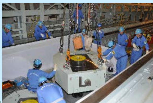
燃料体処理作業の設備機器類の整備
