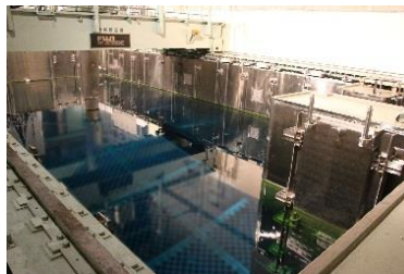
処理が完了した燃料体を貯蔵する水プール
