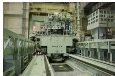
炉外燃料貯蔵槽や原子炉容器から燃料体を取り出すときに使う設備
