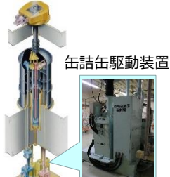
洗浄した燃料体を缶詰缶に封入する設備
