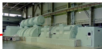
タービン発電機(タービン建物3階)
