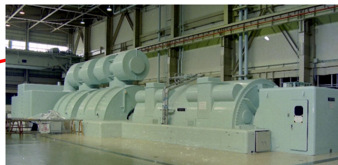
タービン発電機(タービン建物3階)
