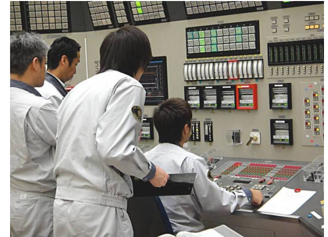
制御棒操作状況
