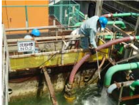
排水処理設備での採水
