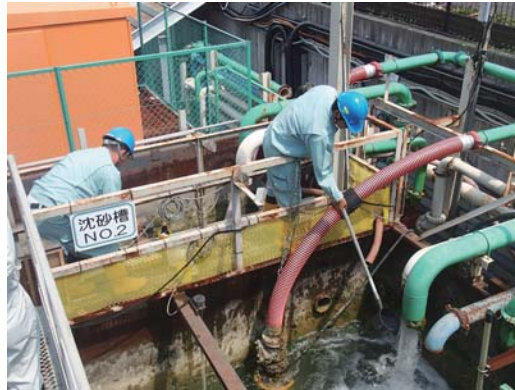
排水処理設備での採水
