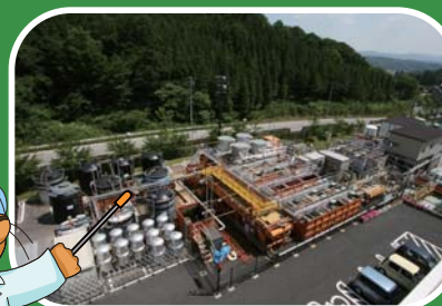
【排水処理設備】
