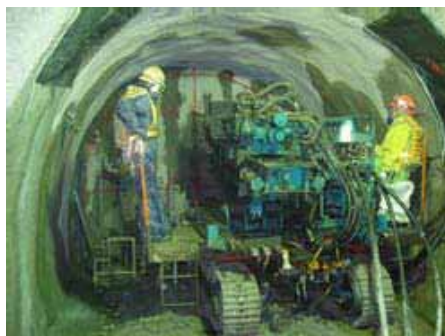
湧き出る地下水を低減させる作業の様子 (深度300mの調査研究用の水平坑道)
