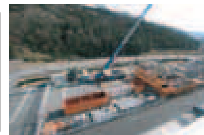
【増強中の排水処理設備の様子】
