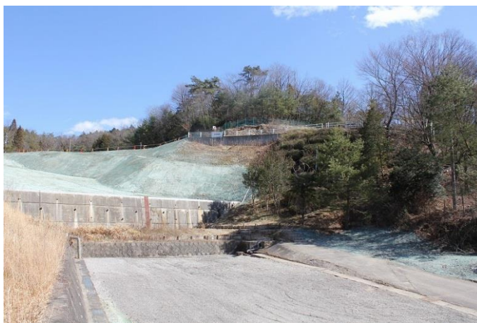
主要な地上施設解体撤去後の東濃鉱山の状況 (平成 28 年 3 月)
