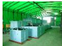
塩水リユース設備
