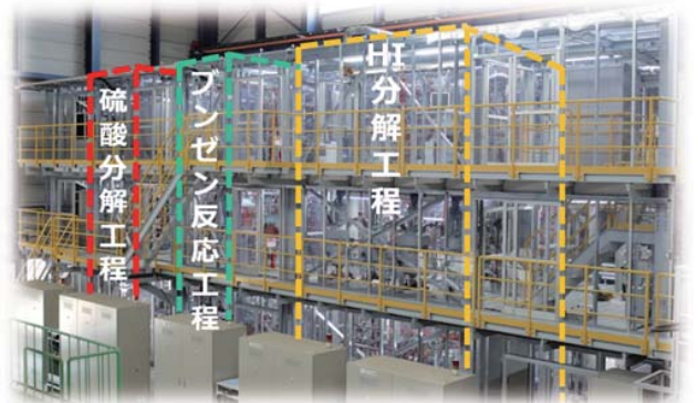
▲熱化学法ISプロセスによる水素製造試験装置
