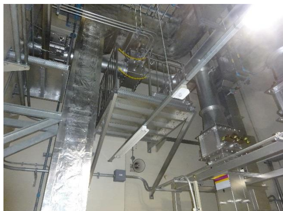
写真 2.1.21-3 MLF 自動ダンパ点検用架台
