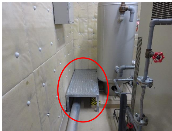
写真 2.1.21-2 MLF 圧縮空気機械室踏み台
