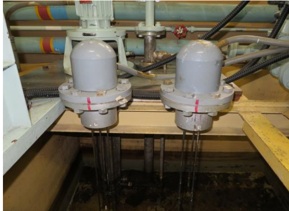
写真 2.1.4-2 NSRR 廃液処理室サンプルピット水位高の電極(左側が警報)
