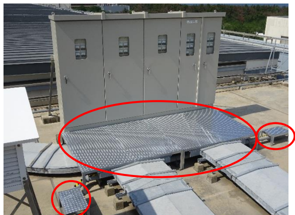
写真 2.1.21-1 MLF 屋上動力盤廻り踏み台
