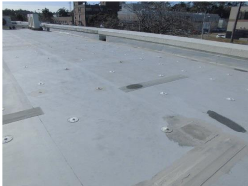
写真 2.10.1-1 ホットラボ 屋上防水 補修前
