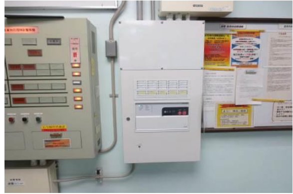
火災受信機設置状況(更新後)
