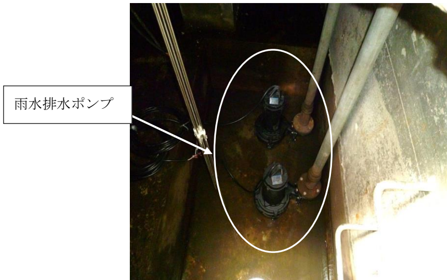
写真 2.1.13-1 雨水排水ポンプ更新後
