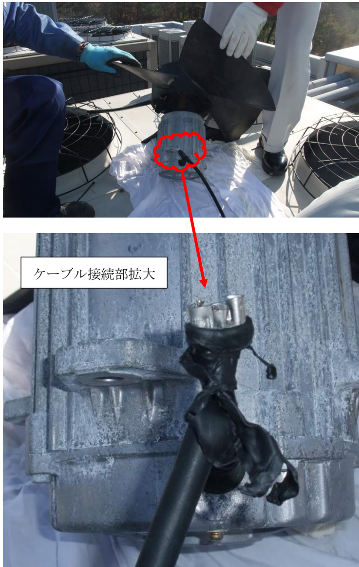
写真 2.7.2-1 冷却ファン電動機電源ケーブル接続部
