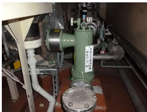
写真 2.1.6-1 廃液貯槽No.4 排水ポンプ更新後
