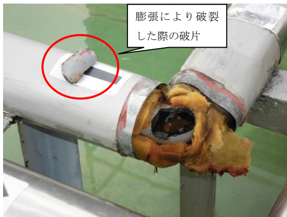
写真 2.1.9-1 継手部の破裂箇所
