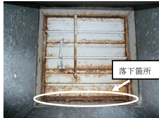
写真 2.1.18-4 ダクト内部モーターダンパー (富岡 達也)
