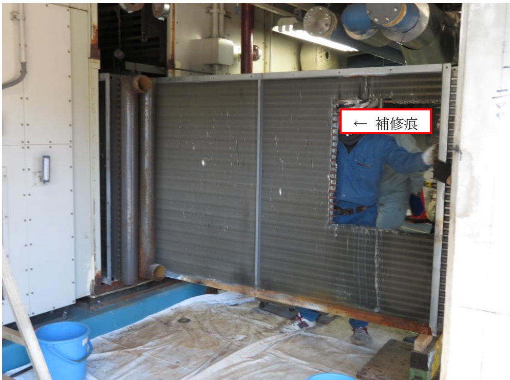
JRR-3 実験利用棟ビームホール系空調機用のコイル(更新前)
