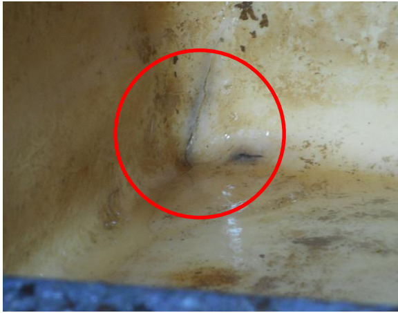
写真 2.1.7-2 下部水槽の割れ箇所
