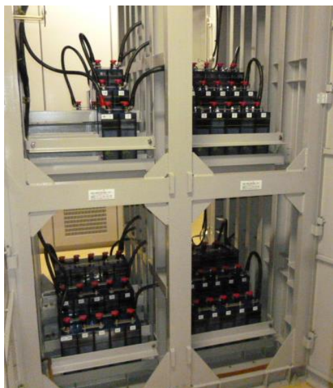
写真 2.10.7-1 UB 系蓄電池 (交換前)
