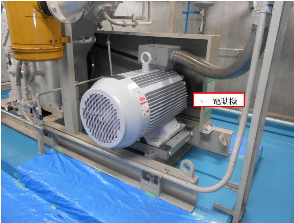
実験利用棟実験装置系空気圧縮機用電動機(更新後)
