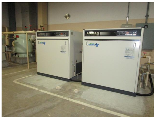
写真 2.1.11-1 設置したスクリー型空気圧縮機
