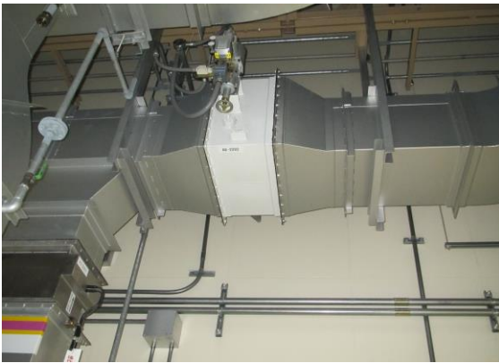
写真 2.10.4-1 ダンパ更新前
