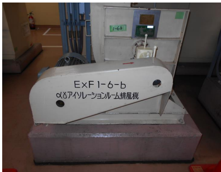
写真 2.1.8-2 更新後の排気第 1-6b 排風機
