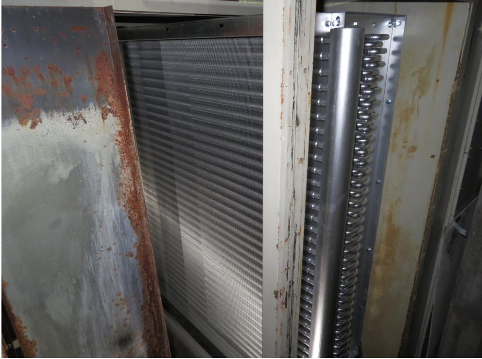
JRR-3 実験利用棟ビームホール系空調機用のコイル(更新後)
