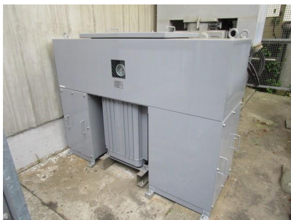
写真 2.1.11-3 更新した油入変圧器
