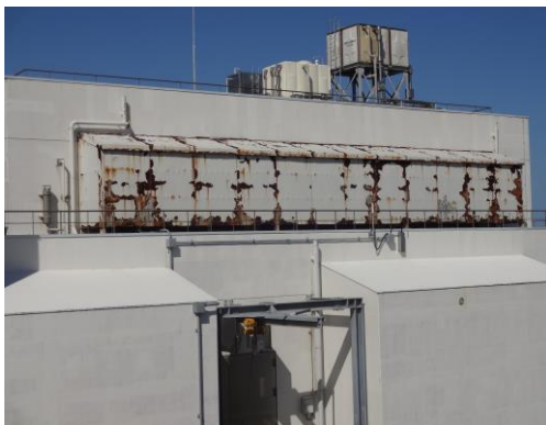
写真 2.1.5-1 外気取入フード補修前
