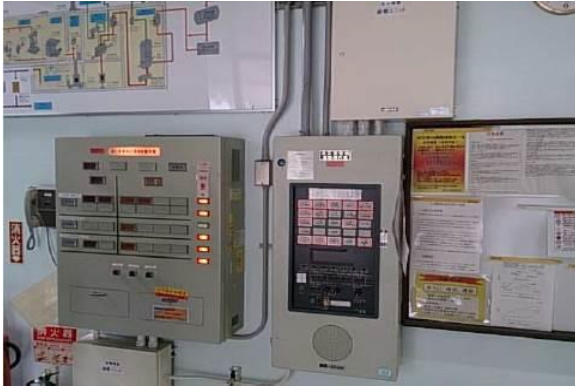
火災受信機設置状況(更新前)
