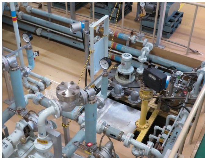
写真 2.1.4-1 NSRR 廃液処理室サンプルピット水位高警報の設置状況
