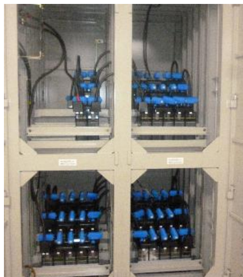
写真 2.10.7-2 UB 系蓄電池 (交換後)
