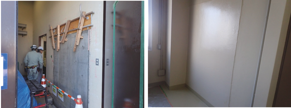
写真 2.1.28 冷却塔ポンプ室開口閉塞
