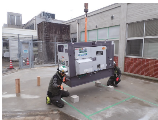
写真 2.1.5 可搬型発電機設置状況
