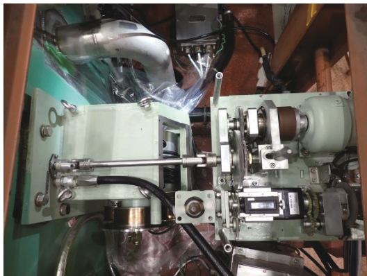
写真 3.1.2.4 起動系駆動装置全体
