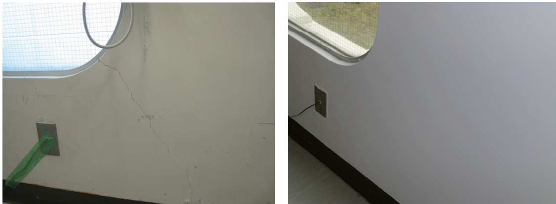
図 2.3.1 制御棟 制御室壁面の損傷及び復旧状況
