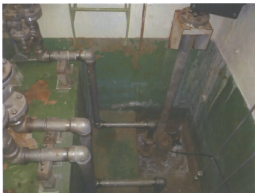
図 2.1.16 使用済燃料貯槽室排水ピット (補修前)
