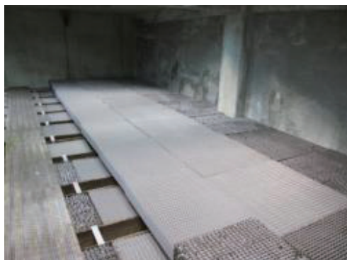
図 2.1.10 エリミネータ更新後の冷却塔内部
