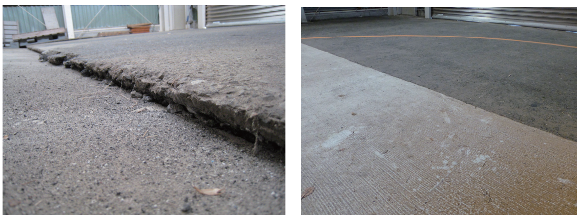
図 2.3.2 風除室 路盤の損傷及び復旧状況
