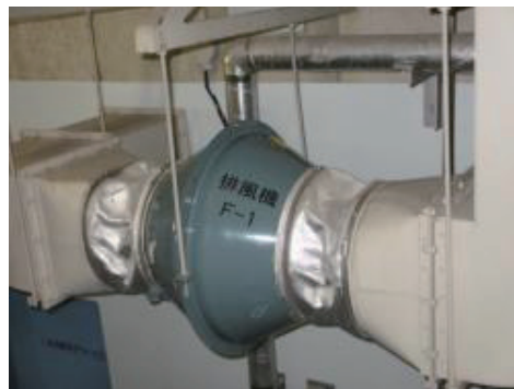
図 2.1.14 更新後のラインファン
