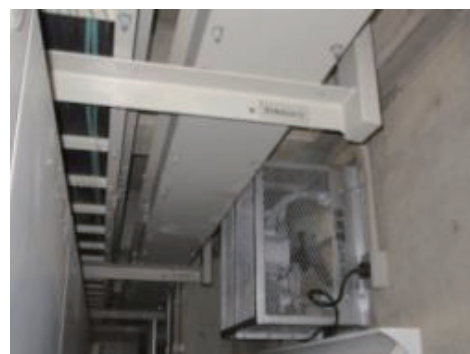
図 2.1.15 更新後のユニットファン
