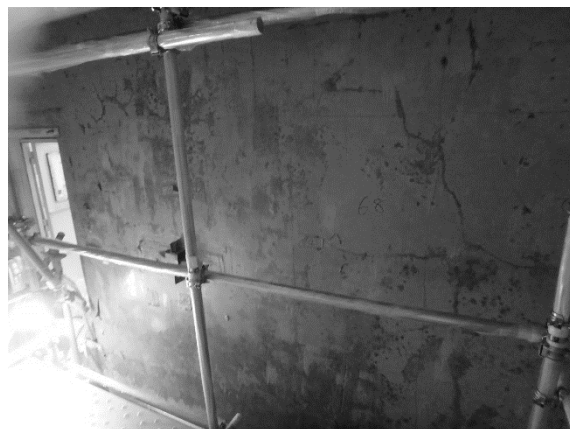
Pu セルの汚染固定前
