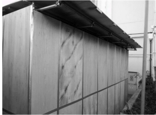
屋外のグリーンハウスの設置状況 (コンパネによる区画)
