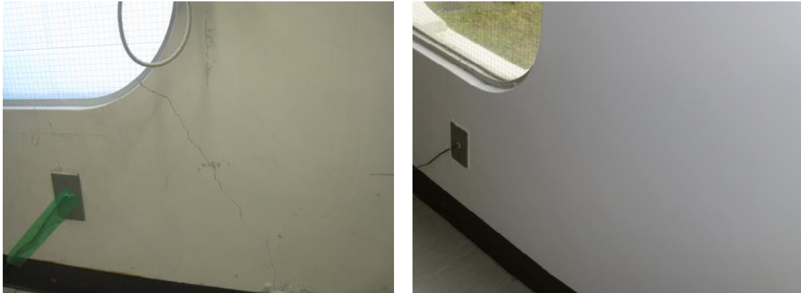
図Ⅲ-1-7 制御棟 制御室壁面の損傷及び復旧状況
