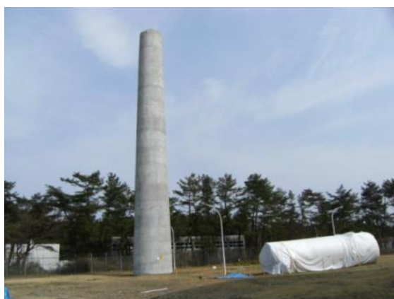
一部が倒壊した排気筒
