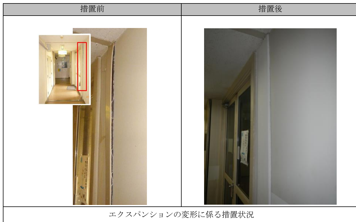
図Ⅲ-1-13 燃料試験施設の主な被災箇所の措置状況
