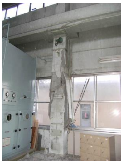
15ton クレーン室の倒壊(柱の座屈)
