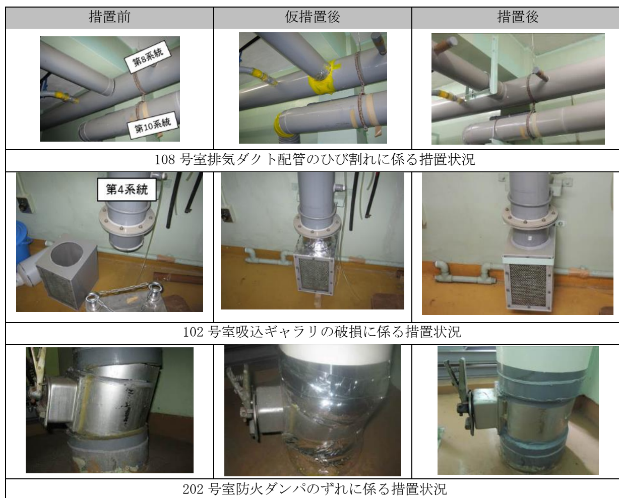
図Ⅲ-1-16 プルトニウム研究1棟の主な被災箇所の措置状況 (1/2)
