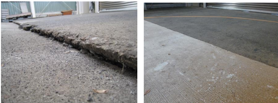
図Ⅲ-1-8 風除室 路盤の損傷及び復旧状況
