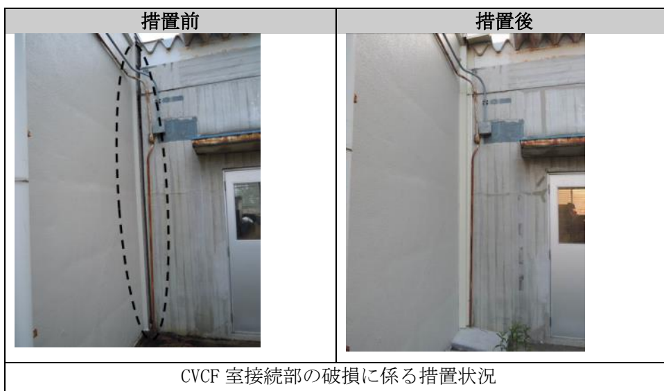
図Ⅲ-1-16 プルトニウム研究 1 棟の主な被災箇所の措置状況 (2/2)
