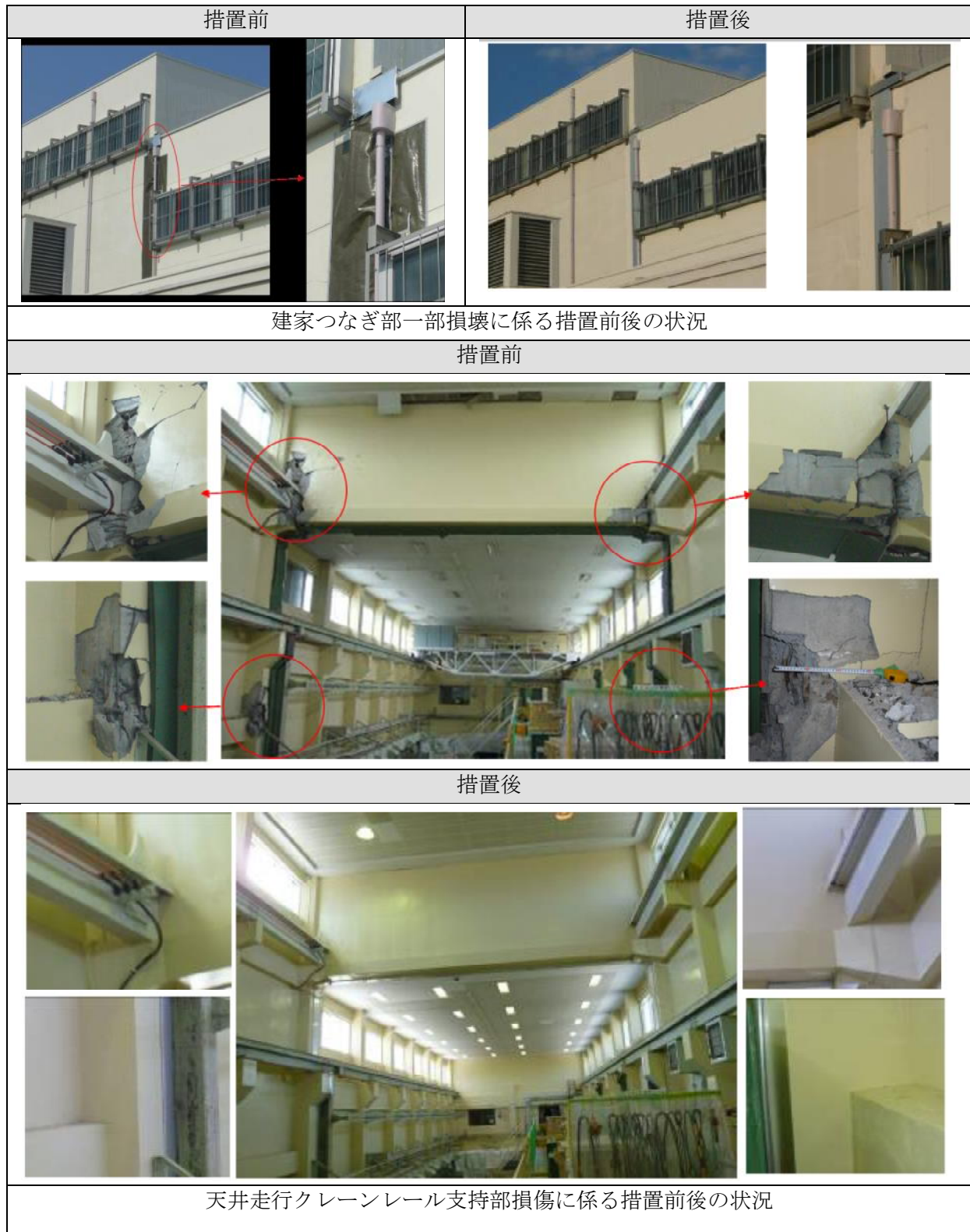
図Ⅲ-1-19 ホットラボの主な被災箇所の措置状況
