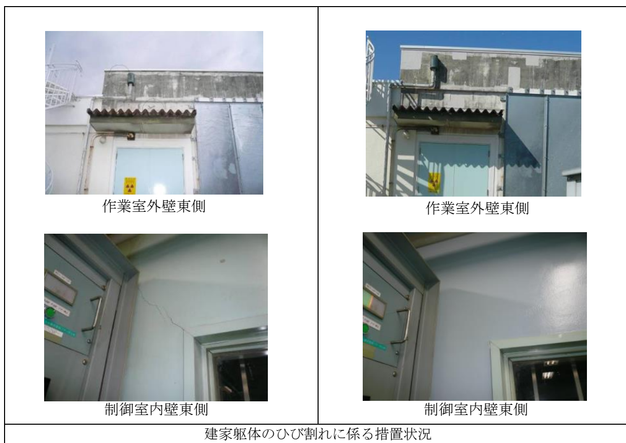
図III-1-11 TCA の主な被災箇所の措置状況
