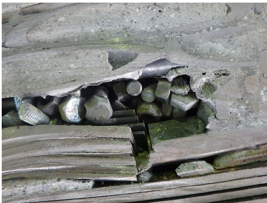
写真 44 試験体の断面(充填材の P ロート流下時間 52 秒)の未充填部(ボルト・ナット部)拡大
