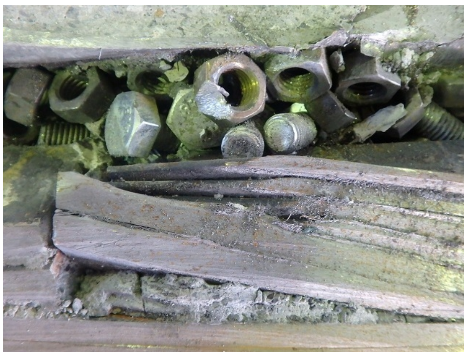
写真 40 試験体の断面(充填材の P ロート流下時間 34 秒)の未充填部(ボルト・ナット部)拡大
