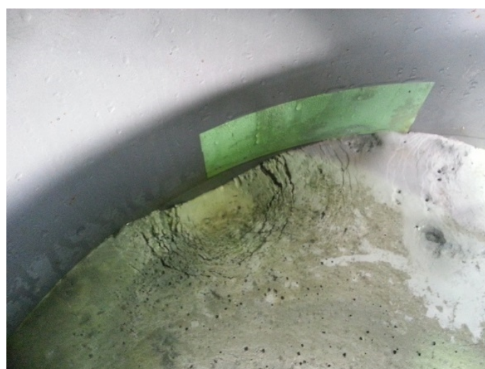
写真 27 P ロート流下時間 20 秒のモルタルを充填した試験体の沈下後の状況
