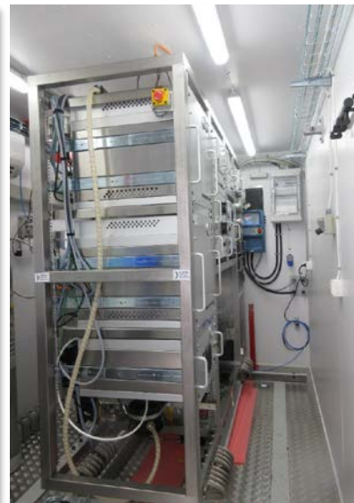
幌延町での設置と室内の様子
