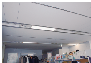
照明の間引き節電
