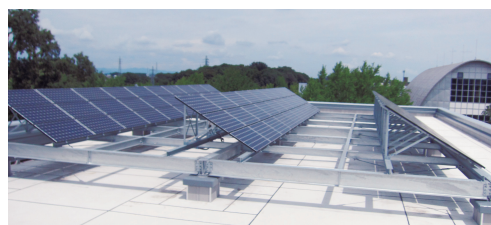
太陽光発電設備
