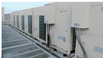
ヒートポンプ式空調室外機
