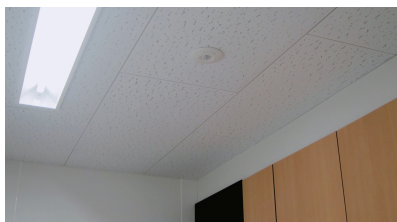
給湯室の人感センサー付LED照明
