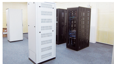
保温材で囲まれたサーバー室
